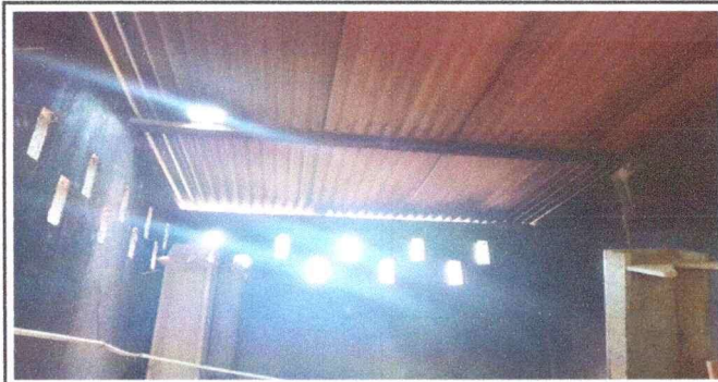
Foto 4: Se observa la necesidad de sustituir la estructura de madera a metal. Modulo 1
