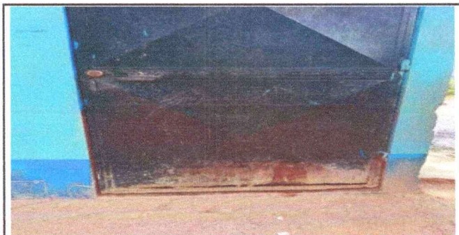
Foto 6: Se observa la necesidad de sustituir la puerta de la direccion en el Modulo 2.
