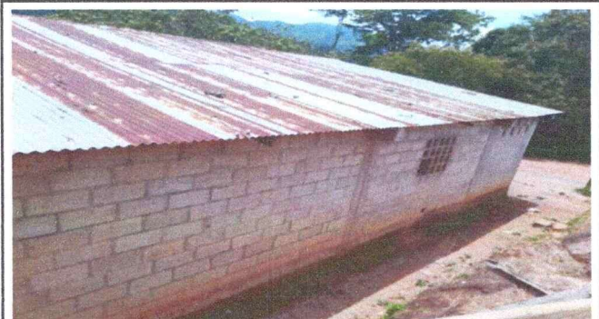
Foto 2: Se observa la necesidad de colocar ventanas y balcones para ventilacion. Modulo 1
