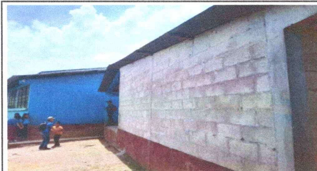
Foto 3: Se observa la necesidad de elevar 2 hiladas de block a la estructura portante. Modulo 1
