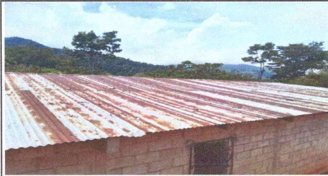
Foto1: Se observa el deterioro de las cubiertas de lamina. Modulo 1
